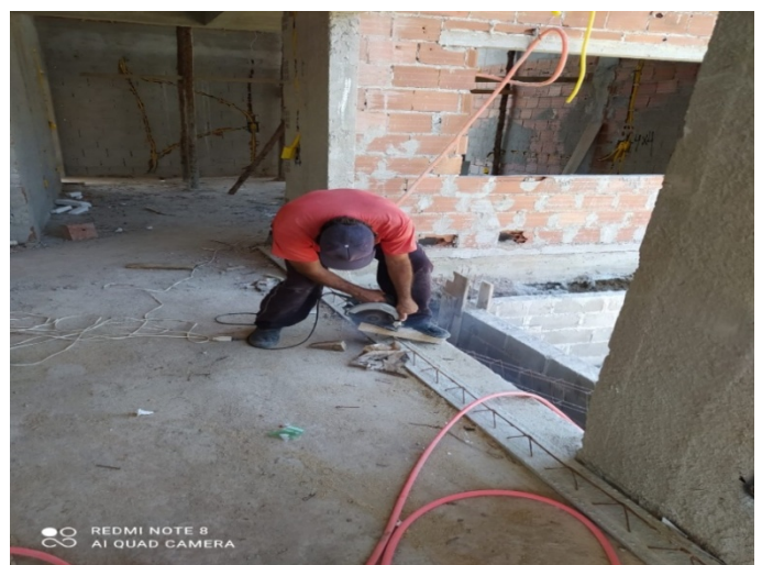
Figura 8. Operários trabalhando sem uso de nenhum EPI, ferramentas espalhadas e fazendo uso de bancada improvisada
